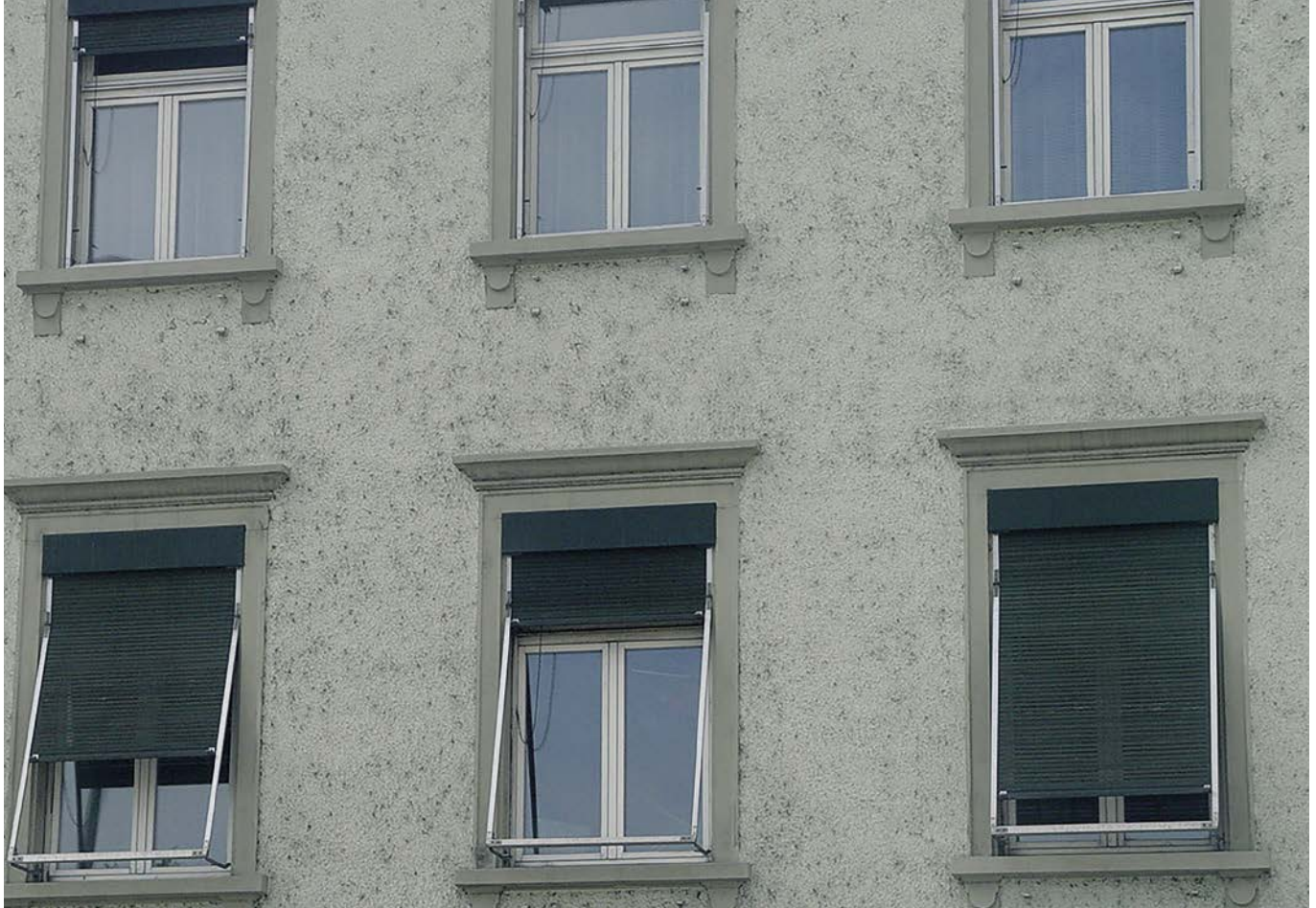
Bild 2 Fassade mit Netzen (dunkle Flecken)
