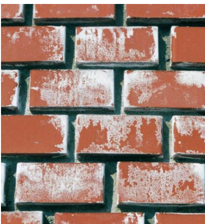
Sulfatausblühungen aus Sichtbausteinen
