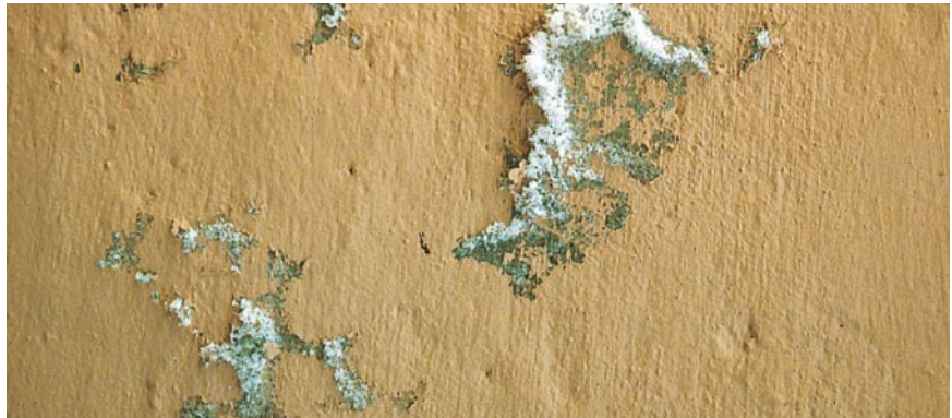
Anstrichschäden durch auskristallisierende Salze
