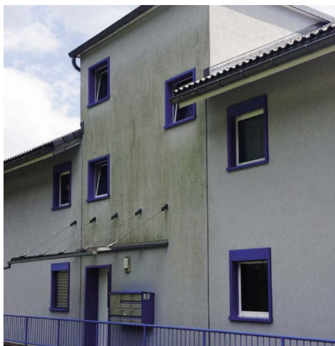
(Abb. 14) Fehlender konstruktiver Feuchteschutz
